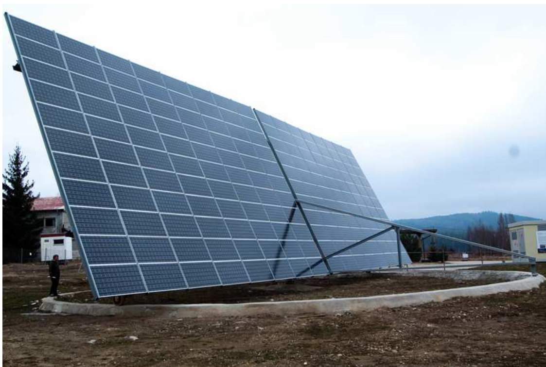
Obr. 2.8.: Strašice – natáčivá fotovoltaická elektrárna
