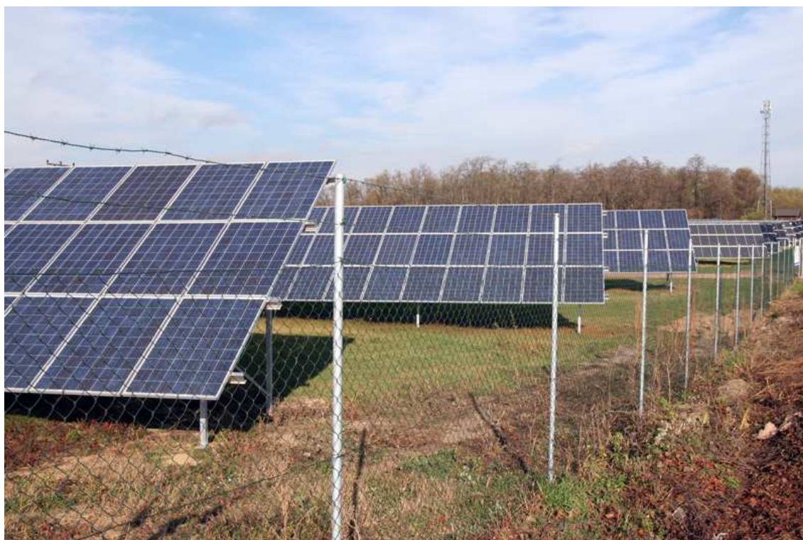
Obr. 2.1.: Fotonvoltaická elektrárna Dubňany
