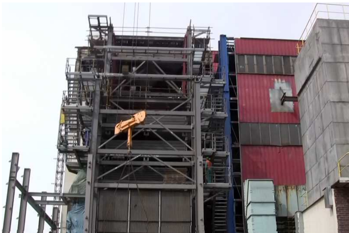
Obr. 4.2.: Kotel (Plzeňská teplárna)
