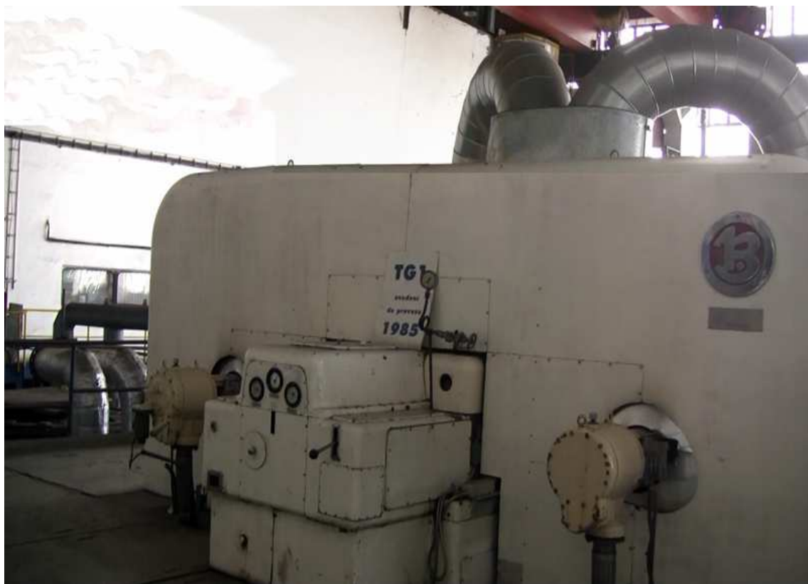
Obr. 4.3.: Turbína (Plzeňská teplárna)
