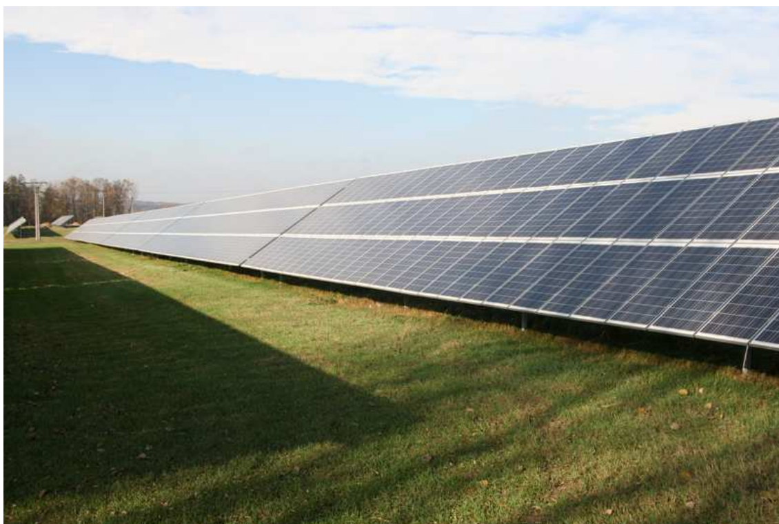
Obr. 1.17.: Fotovoltaická elektrárna Dubňany
